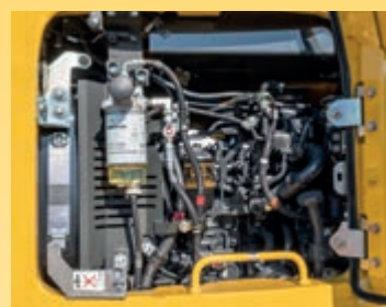
Centraal gemonteerde filters
